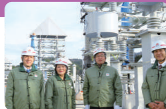
東西日本の電力融通を可能に建設工事中の飛騨変換所を訪問
